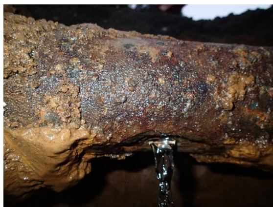
H28 共用施設棟 2 付近での漏水
