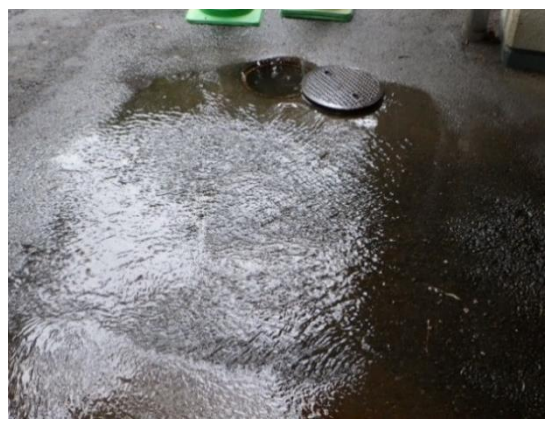
配管からの漏水
