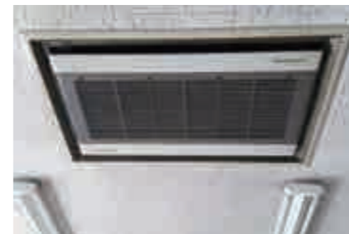
着工前 空調機 照明
