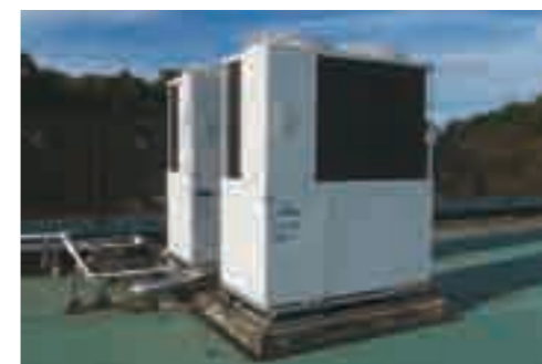
着工前 空調室外機
