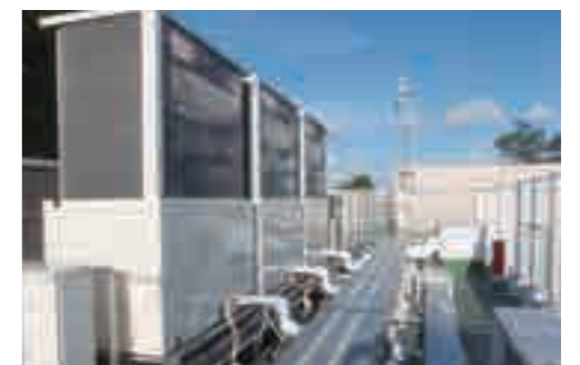
完成後 高効率空調室外機
